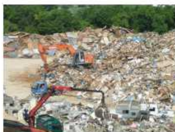
道路横に積み上げられた災害廃棄物
