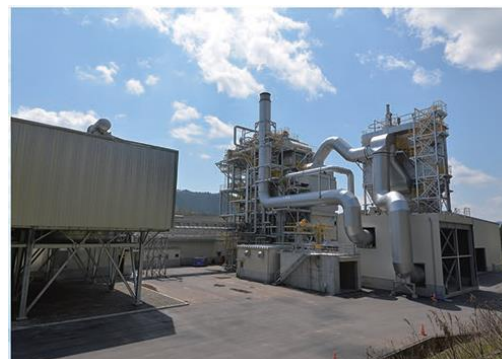
バイオマス発電(岡山県真庭市)
