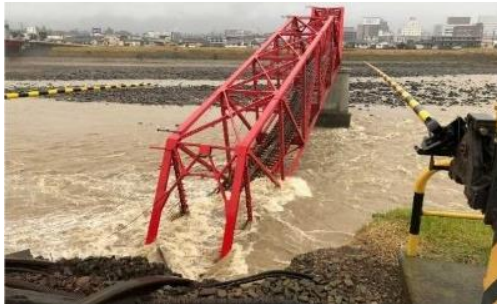
長野県上田市（画像：国土交通省） 橋梁が倒壊し、鉄道が不通となりました。
