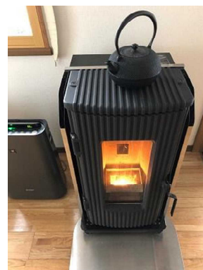
補助により設置したペレットストーブ
