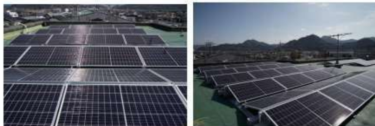
平川地域交流センター太陽光パネル設置状況
