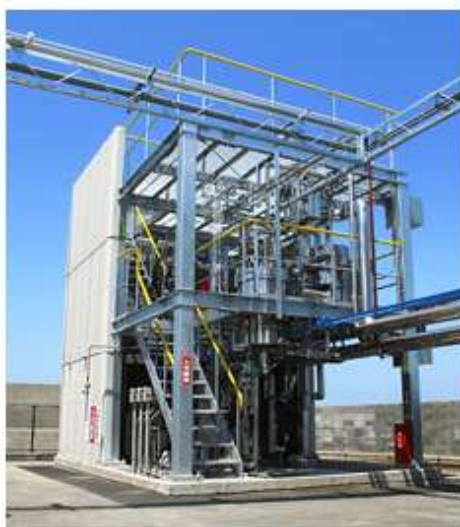
D・Oil N製造プラント<蒸留精製装置>
