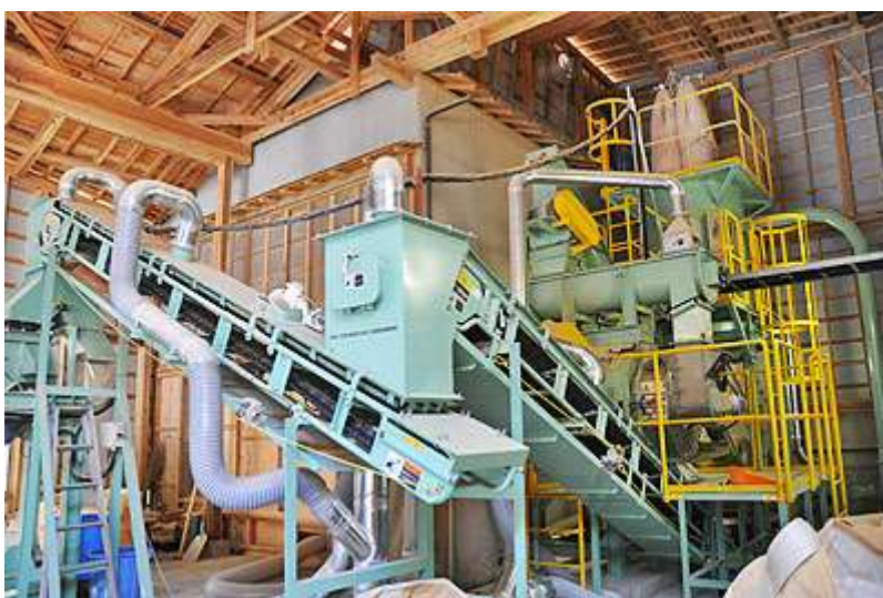
図 3-10 燃料用木質ペレット製造設備
