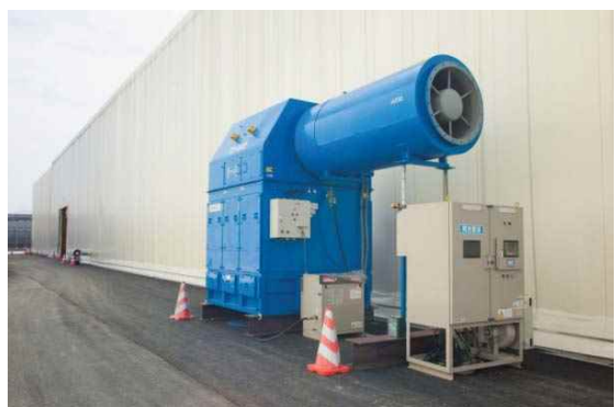
写真 3-5-26 集じん換気装置
