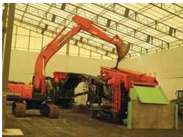
災害廃棄物中間処理施設
