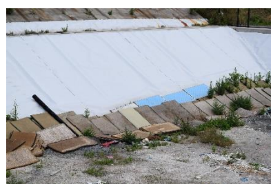
遮水シート保護材の廃置
