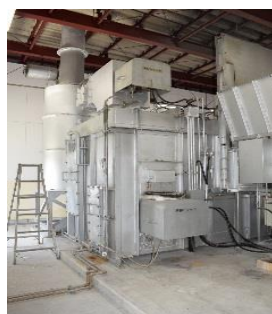
バッチ式の焼却炉
